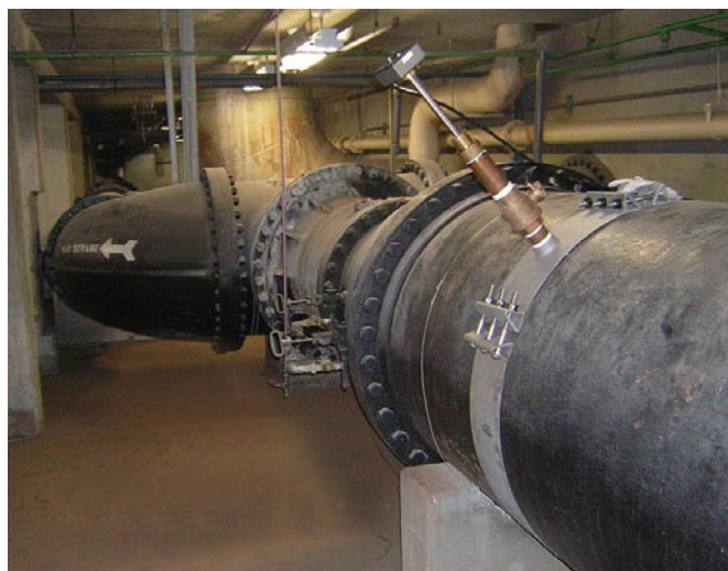
HotTap nahrazující Venturiiho průtokoměr
